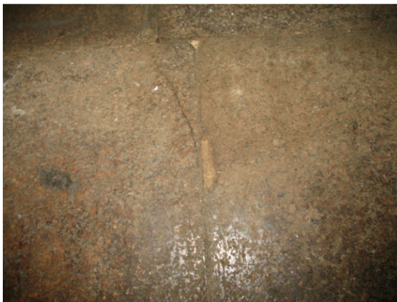
Fissure en partie haute du bloc linteau
