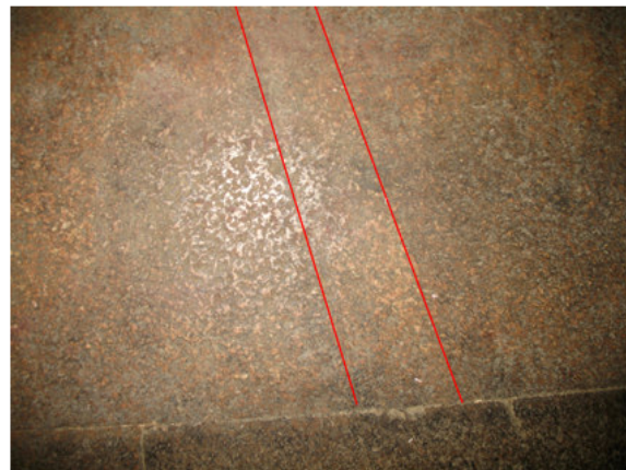
Fissures en partie basse du bloc linteau
