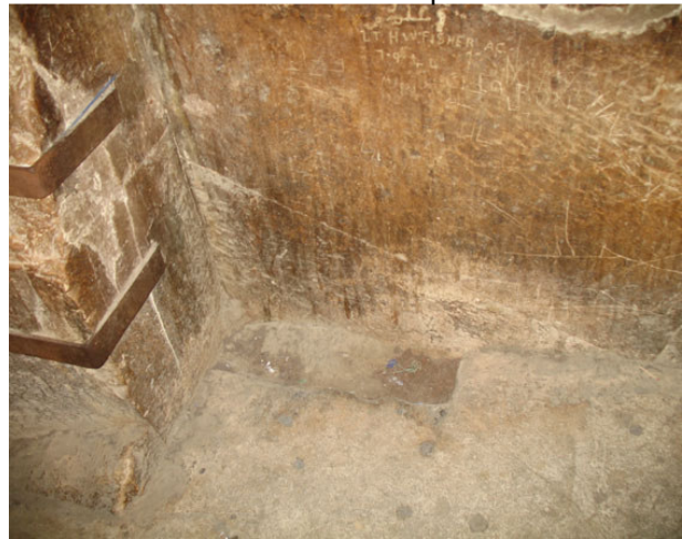
Trous sur le quai
