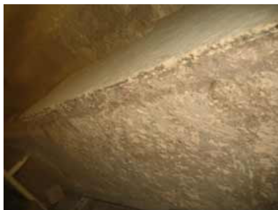
Traces brunâtres sur les banquettes
