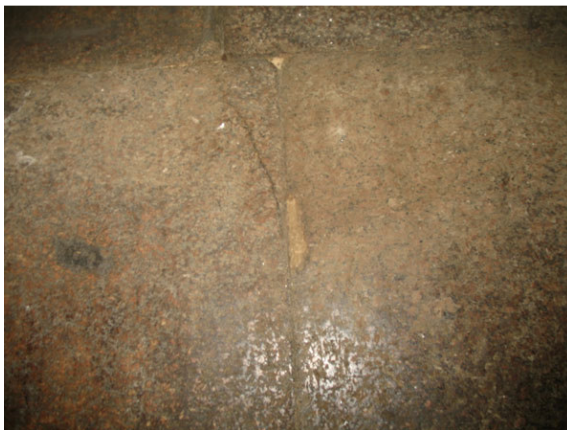
Fissure en partie haute du bloc linteau
