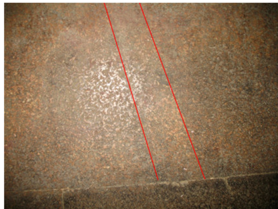
Fissures en partie basse du bloc linteau
